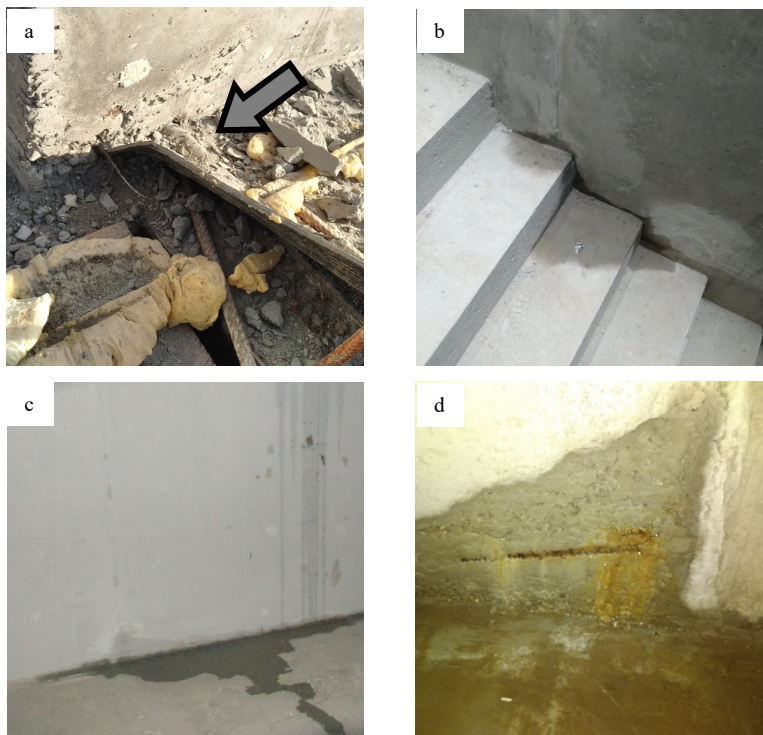
Rys. 2. a) Taśma ASI200 zabezpieczająca styk zagnieciona przez źle ustawiony szalunek; b), c) przeciek na styku elementów (przyczyna nieustalona); d) przeciek z powodu źle zawibrowanej mieszanki [5]
