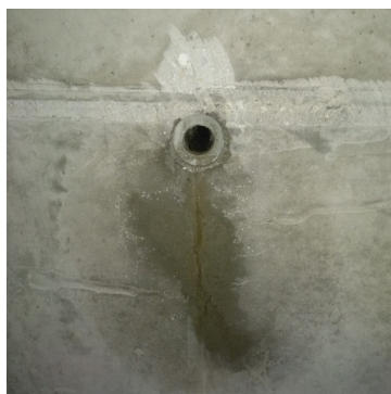
Rys. 5. Błędnie zabezpieczony element po ściągu szalunkowym; ciemne przebarwienia to miejsce zacieku [5]
