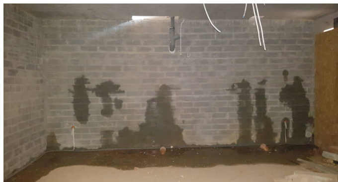
Rys. 3. Liczne przecieki na wewnętrznej stronie ściany przy błędnie wykonanej izolacji powłokowej [5]
