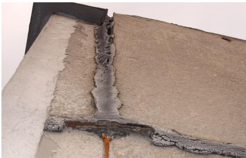
Rys. 2. Wychylenie prefabrykatu ściennego w rejonie górnego naroża budynku (fot. własna)
