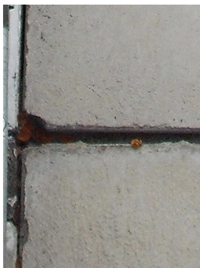
Rys. 5. Brak bariery przeciwdeszczowej pomiędzy płytami ściennymi
